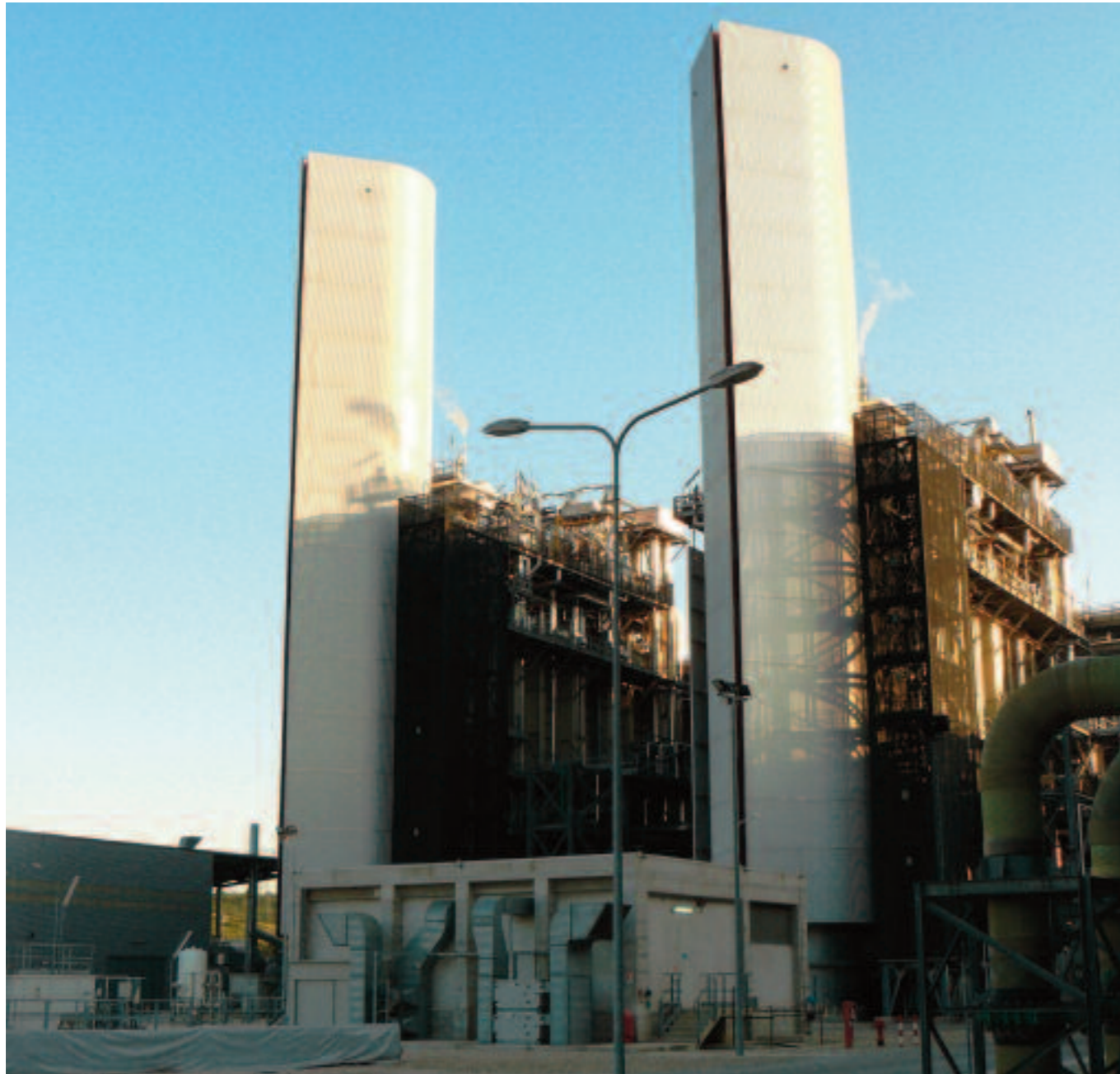
Fig. 1 - I camini della Centrale di Termoli e sullo sfondo i generatori di vapore a recupero.
