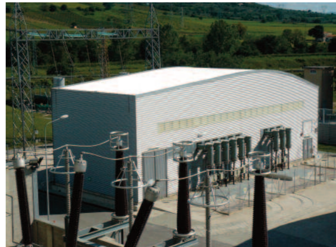
Fig. 9 - L'edificio elettrico della Centrale. È l'interfaccia tra i trasformatori della Centrale e l'elettrodotto di collegamento con la Rete di Trasmissione Nazionale.
