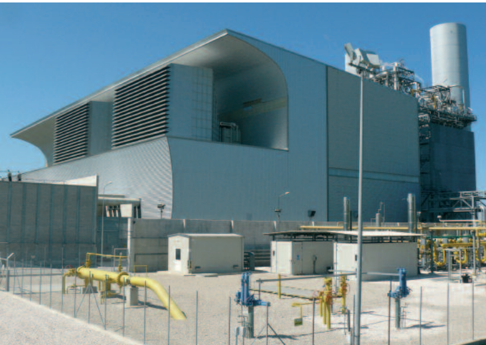
Fig. 2 - In primo piano la stazione di arrivo del gas naturale, sullo sfondo la sala macchine con i filtri di aspirazione dell'aria e il camino.
