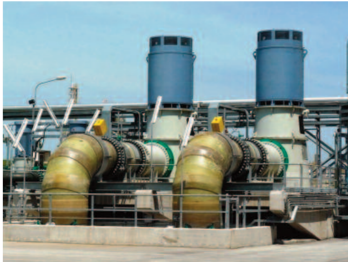
Fig. 6 - Le pompe del circuito di raffreddamento.
