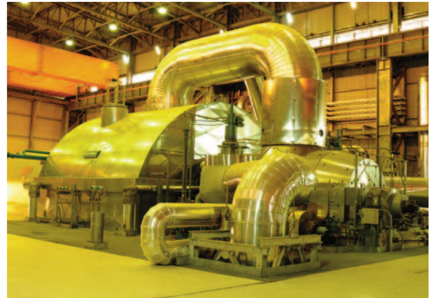
Fig. 5 - La turbina a vapore all'interno della sala macchine.
