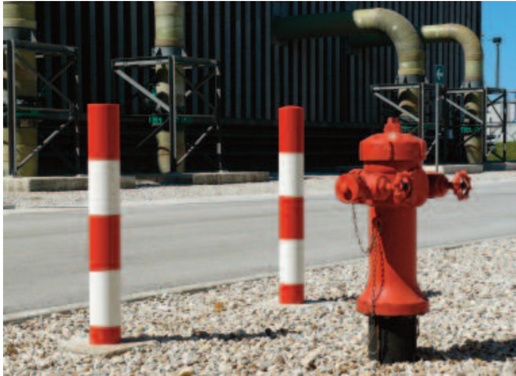
Fig. 11 - Uno dei tanti apprestamenti antincendio presenti in Centrale.
