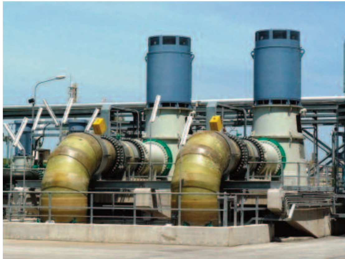
Fig. 5 - Le pompe del circuito di raffreddamento
