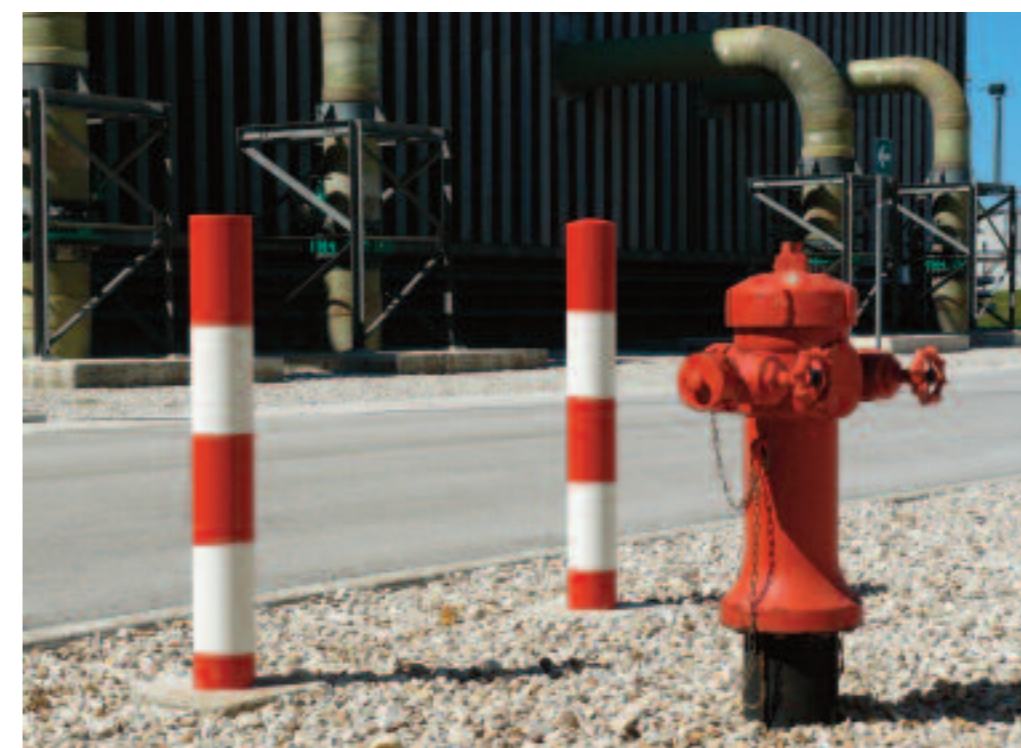
Fig. 10 - Uno dei tanti apprestamenti antincendio presenti in Centrale.
