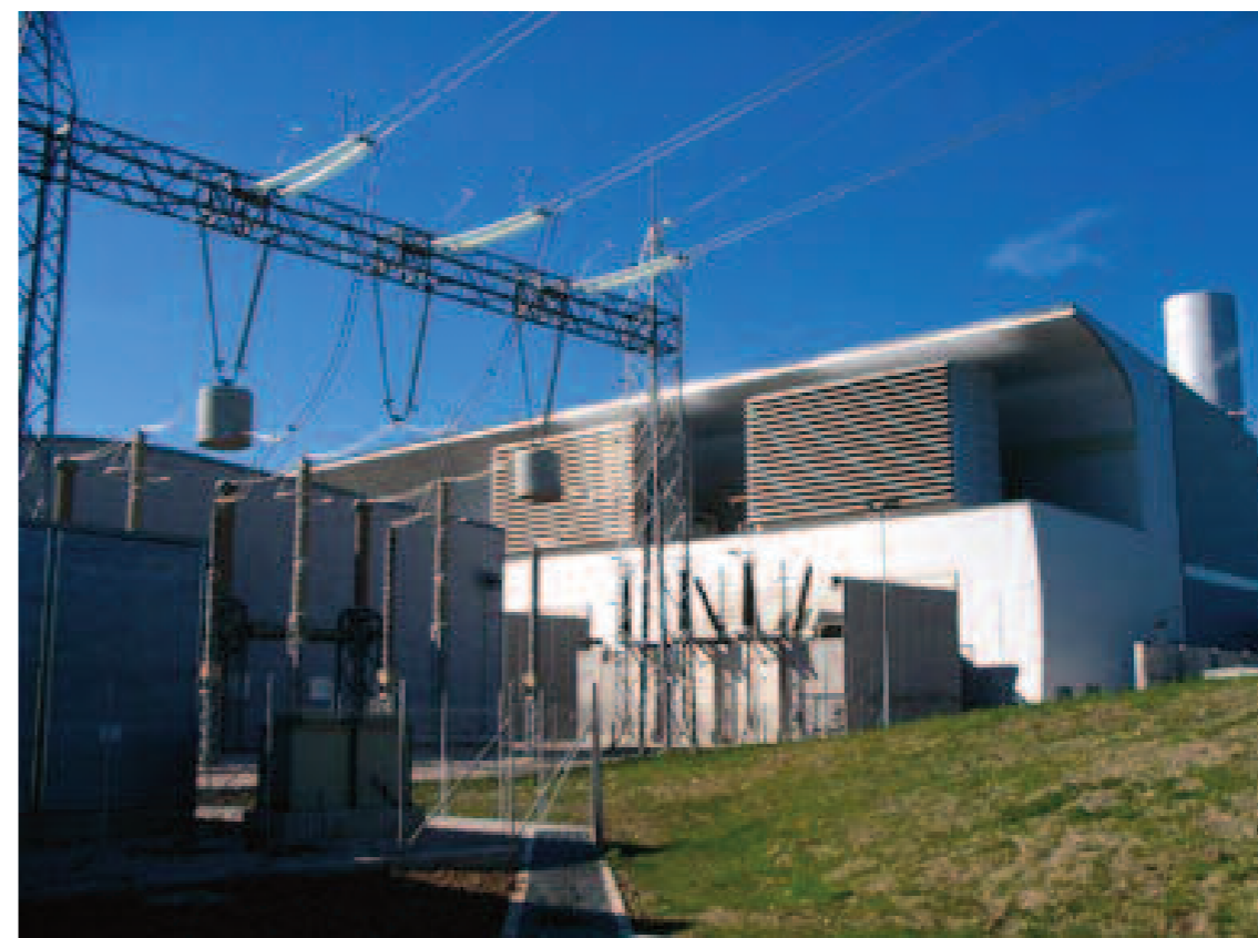
Fig. 7 - Area di interfaccia tra i trasformatori della centrale e l'elettrodotto di collegamento con la Rete di trasmissione Nazionale
