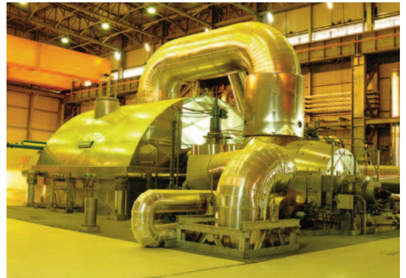
Fig. 4 - La turbina a vapore all'interno della sala macchine.
